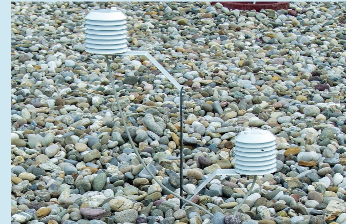
Meetapparatuur op het dak. (Foto: Michiel Rijsdijk)
