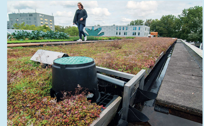
Klepsturing op groen sedum dak met groente- en kruidentuin van het in het gebouw gevestigde restaurant. (Foto: Dakdokters)
