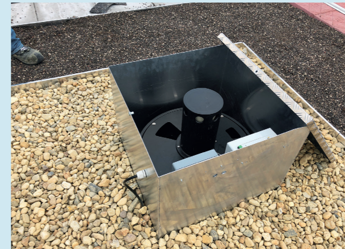
Smart Flow Control in de controleschacht. (Foto: Opitgrün International AG)
